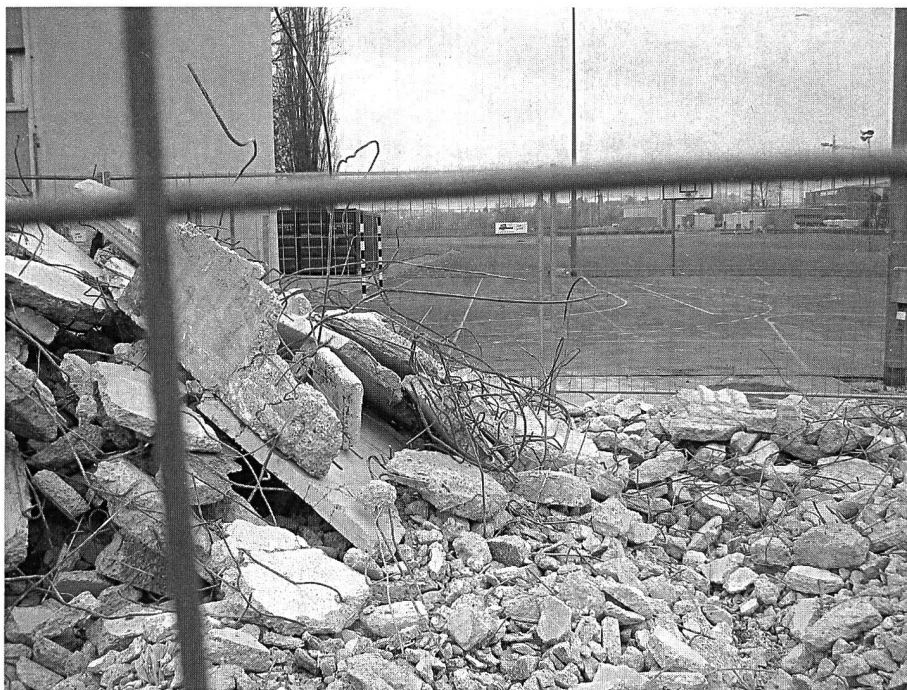
Überreste der Aussengerätegaragen Turnhallen Paradiesli.
