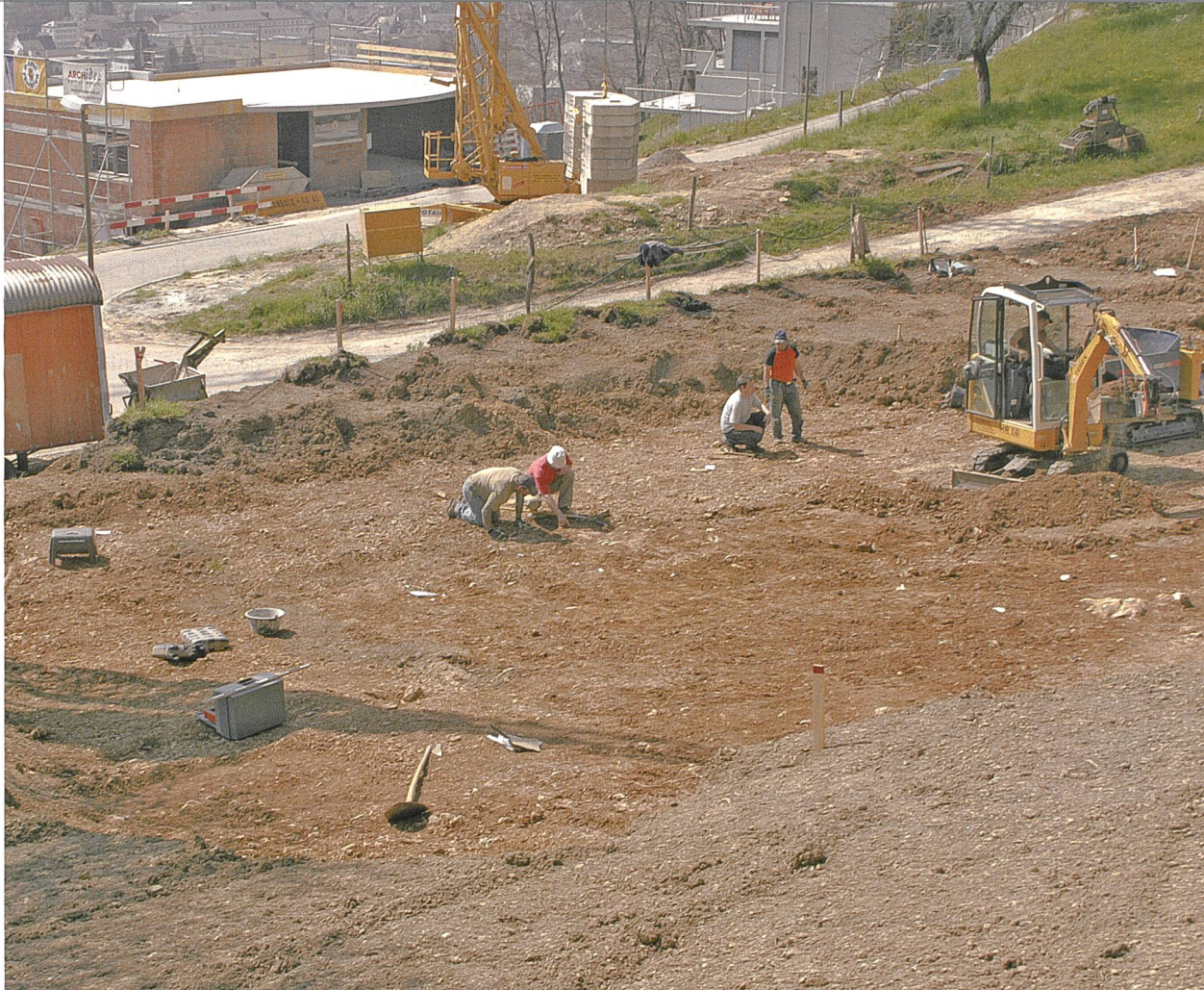
Liestal, Hurlistrasse. Das Team beim Freilegen der Kalk- schuttoberfläche auf der Hangterrasse.
