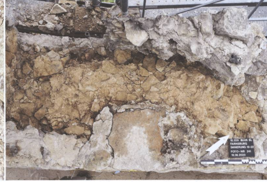
Gleiche Schäden, aber bereits vor Jahrzehnten saniert. Aufsicht auf die Ringmauer, aus der Burgzeit ist nur der Kern aus gelbem Mörtel erhalten geblieben (ProSpect GmbH).
