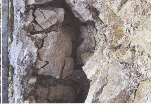
Ein vergleichbarer Schaden an der Ringmauer – nun in der Seitenansicht. Die Mauerschale ist durchgefroren und löst sich ab.
