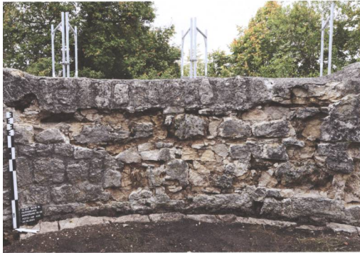
Schadensbilder, wie sie für die Farnsburg typisch sind: Die Innenwand des Blauen Turms nach Entfernung der frostzerstörten Mauersteine (ProSpect GmbH).
