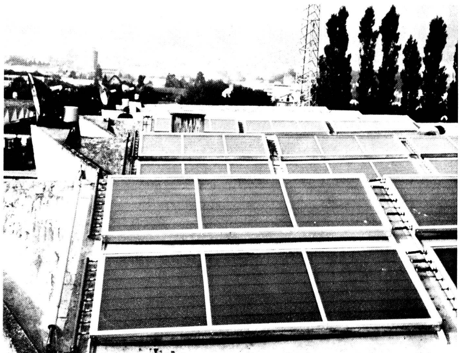
Flachkollektoren auf dem Tribürendach eines Stadions in Grenchen, die das Warmwasser für die Duschanlage aufbereiten. Gemäss verschiedenen Studien können pro Quadratmeter Sonnenkollektorfläche im Jahr mindestens 100 Liter Heizöl eingespart werden.
