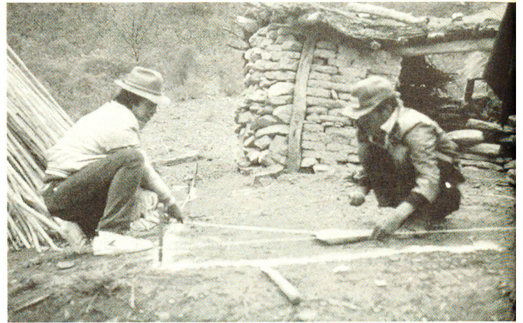
Unter Anleitung und mit lokalen Materialien werden erste Schritte zur Sanierung der Wohnstätten unternommen.
