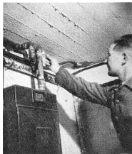
Si vous percevez une odeur de gaz, fermez le compteur et aérez largement la maison. Attention aux flammes nues et aux étincelles. N'employez pas d'allumettes pour découvrir la fuite, mais appliquez de l'eau savonneuse sur le tuyau suspect.
