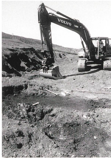
Abb. 79: Riom-Parsonz, Cadra, untere Strassenkurve. Dunkle, steinig-humose Schicht, die während der Baggerarbeiten ans Tageslicht gelangte.
