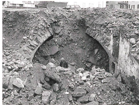
Abb. 70: Chur, Sägenstrasse Nr. 32–34 (Kart-Arena). Einblick in die teils eingerissenen Gewölbe der Kellerräume der Alten Brauerei. Blick gegen Süden.
