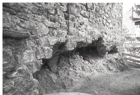
Abb. 107: Brienz/Brinzauls, Burganlage Belfort. Die 1499 unterminierte Nordfassade des Hauptturms.
