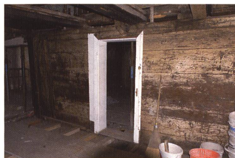
Abb. 68: Chur, Reichsgasse Nr. 57. Eine Zwischenwand des spätgotischen Bohlenbaus im 1. Obergeschoss. Blick gegen Südosten.
