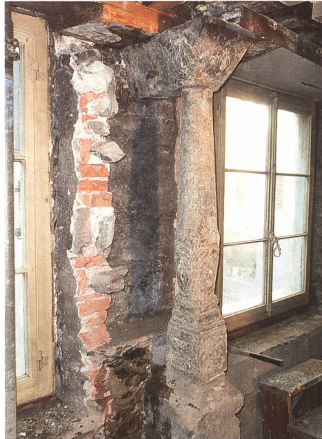
Abb. 69: Chur, Reichsgasse Nr. 57. Freigelegte Fenster-säule in der südlichen Stube des 1. Obergeschosses. Blick gegen Nordwesten.
