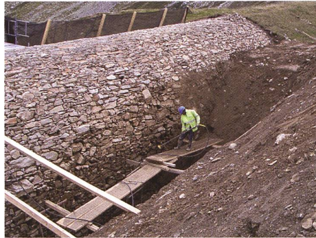
Abb. 130: Splügen, Galerie am Splügenpass. Die äussere Schale des Tunnelgewölbes während der Sanierung.
