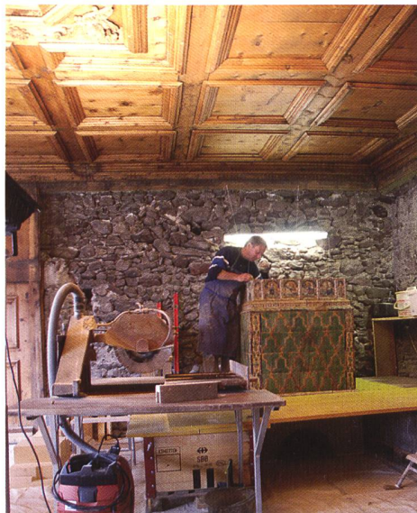
Abb. 128: Müstair, Kloster St. Johann. Das barocke Fürstenzimmer im Westtrakt der Klosteranlage während der Restaurierungsarbeiten.
