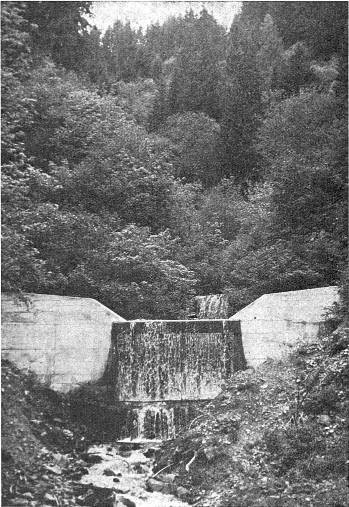
Fig. 10 Barrage artificiel et rive boisée se complètent pour lutter contre l'érosion. Photo F. Bachmann.
