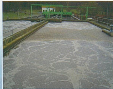
Traitement des eaux usées
