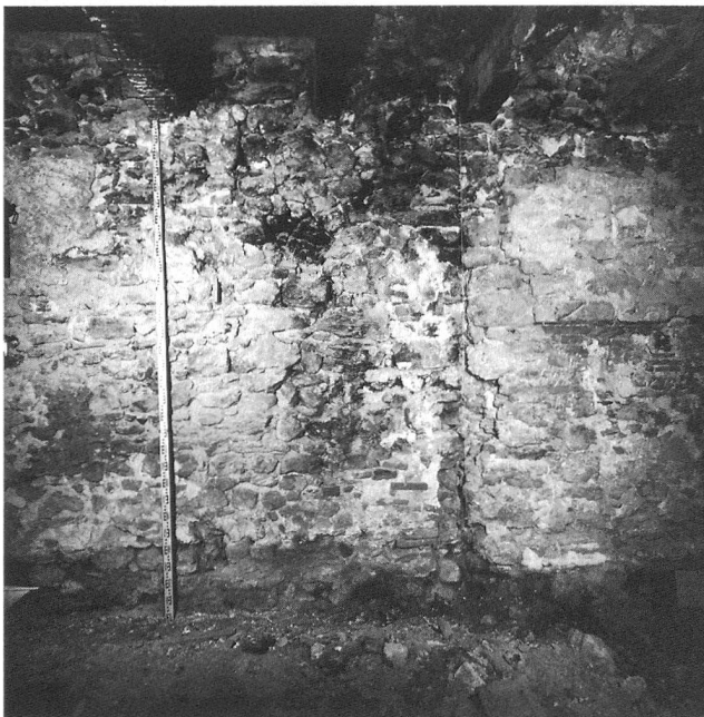
Abb. 8: Biel, Obergässli 5. Der südliche Eckverband von Ostmauer (51) im Erdgeschoss, Blick nach Osten.
