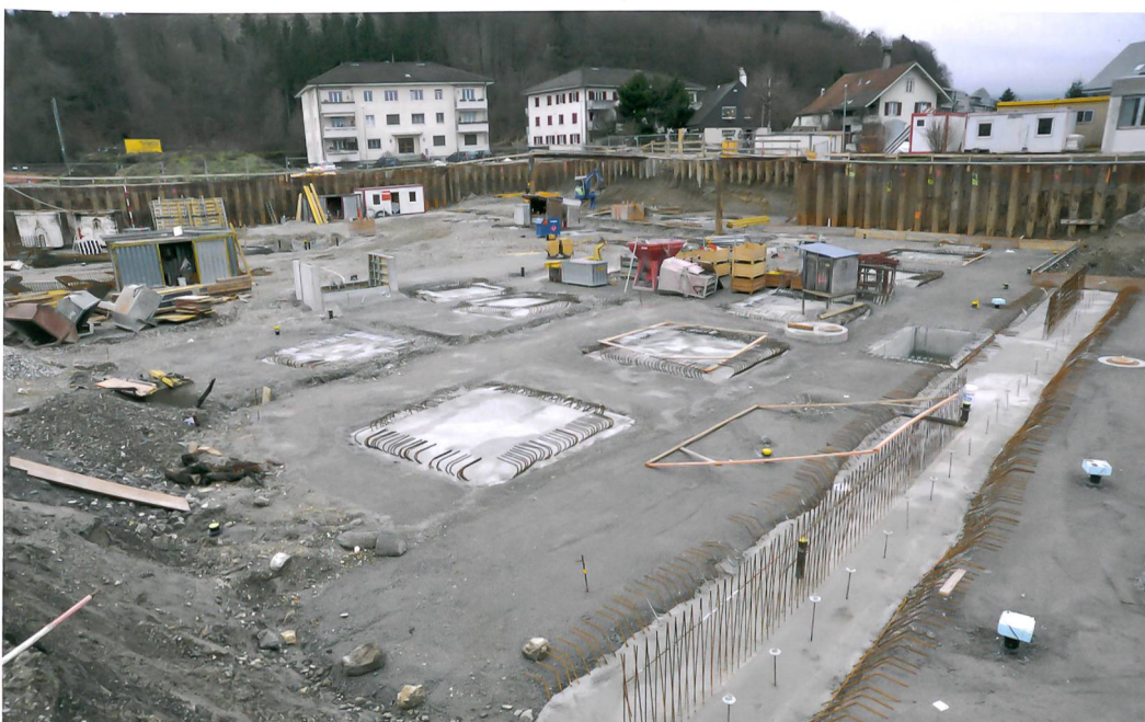
Abb. 1: Studen, Areal Wydenpark. Die Grabung ist abgeschlossen und die Fundationsarbeiten für das Untergeschoss der Grossüberbauung in vollem Gang. Nichts ist mehr zu sehen von Römerstrasse und Holzbrücke.
