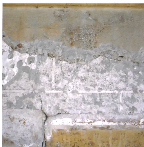
Fig. 5: La Neuveville, Rue du Faubourg 21-25. Restes d'enduit de la phase vert clair imitant un blocage de pierres de taille au-dessus de la fenêtre du 1 er étage. Vue vers le nord-est.
