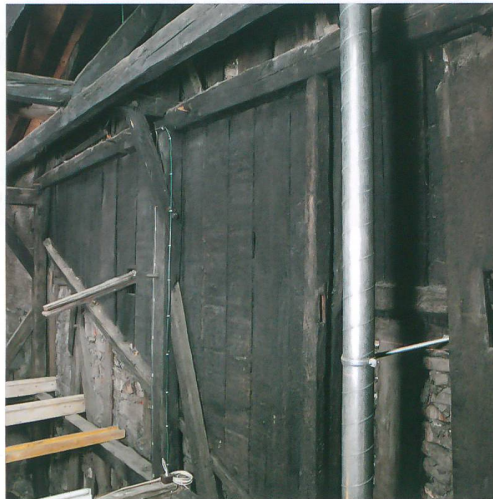
Abb. 16: Thun, Obere Hauptgasse 3. Detail aus dem Dachgerüst des Hauses 7 (kurz nach 1571), Stockwerk des Südostgiebels zwischen den beiden Kehlbalenlagen. Die Verbreiterung war in eine lange Strebe eingunnet, welche die Dachneigung des zurückgebauten Hauses 5 (um 1530) nachzeichnet. Blick nach Südosten.
