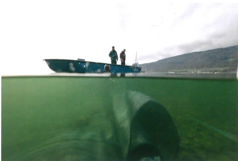
Fig. 9 : Sutz-Lattrigen, Rütte. Pose de la natte géotextile devant protéger la frange d'érosion.
