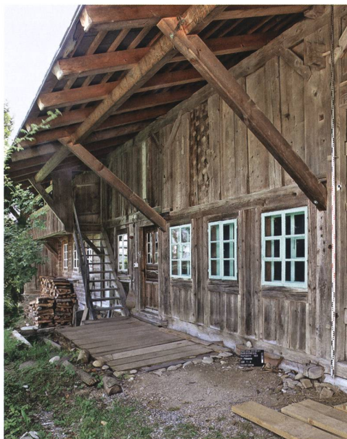
Abb. 10: Rüschegg Sangern 183. Wohntrakt der nördlichen Haushälfte zwischen dem zweiten und vierten Querbund. Die Nebenstube im Vordergrund (Raum 7, Abb. 13) ersetzte einen Schmalviehstall. An den Bundachsenschnittpunkten zeigen sich auf Schwellbalkenhöhe die alten Zapfenschlösser. Gerüst und Gefüge im Dachgeschoss sind überwiegend original. An den Ständerbohlenwänden finden sich die regionaltypischen, tupfenartigen Verzierungen. Blick nach Südosten.
