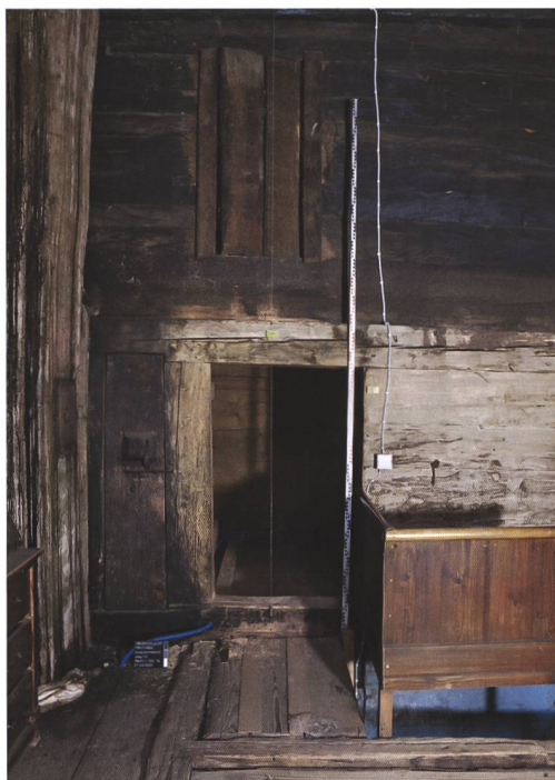
8 Kandergrund, Ausserrüti 121. Nordwand der Rauchküche auf Höhe des Gadengeschosses. Im Boden sind die Balken der Galerie erhalten. Hinter dem Kamin links befindet sich die Originaltüre, welche verschlossen und an die heutige Stelle verschoben wurde. Blick nach Norden.
