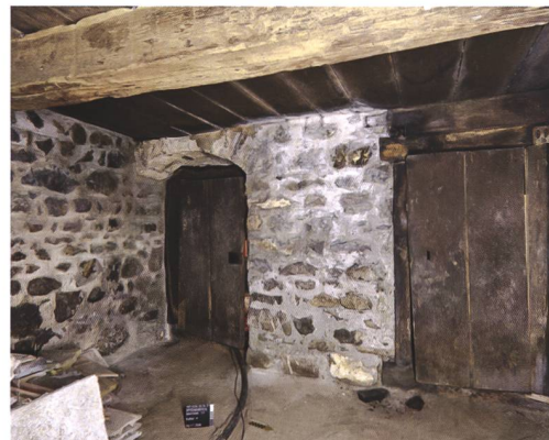
4 Reichenbach, Kientalstrasse 12. Keller K4. Durch die Binnentüre links ist der Keller K3 zu erreichen. Der gewölbte Türsturz ist aus Tuffblöcken gesetzt. Durch die rechte Binnentüre war die Treppe in die Rauchküche erschlossen. Blick nach Südwesten.
