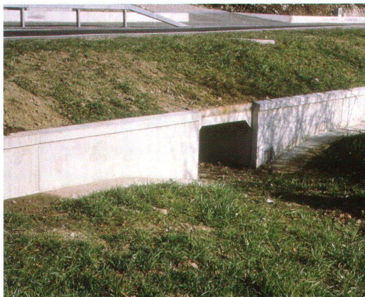
Abb. 17: Ein Betondurchlass ermöglicht nicht nur Amphibien, sondern auch anderen Kleintieren ein gefahrloses Überqueren von Strassen.
