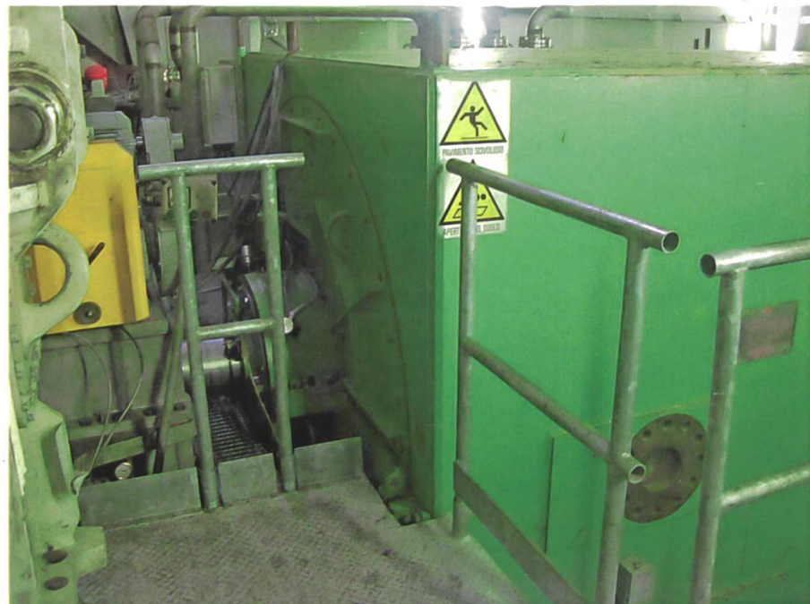
Abb. 25: Turbinen-Generatorübergang beim geothermischen Kraftwerk Sasso II in Larderello – 16 MWe / Foto: M. Eberhard
