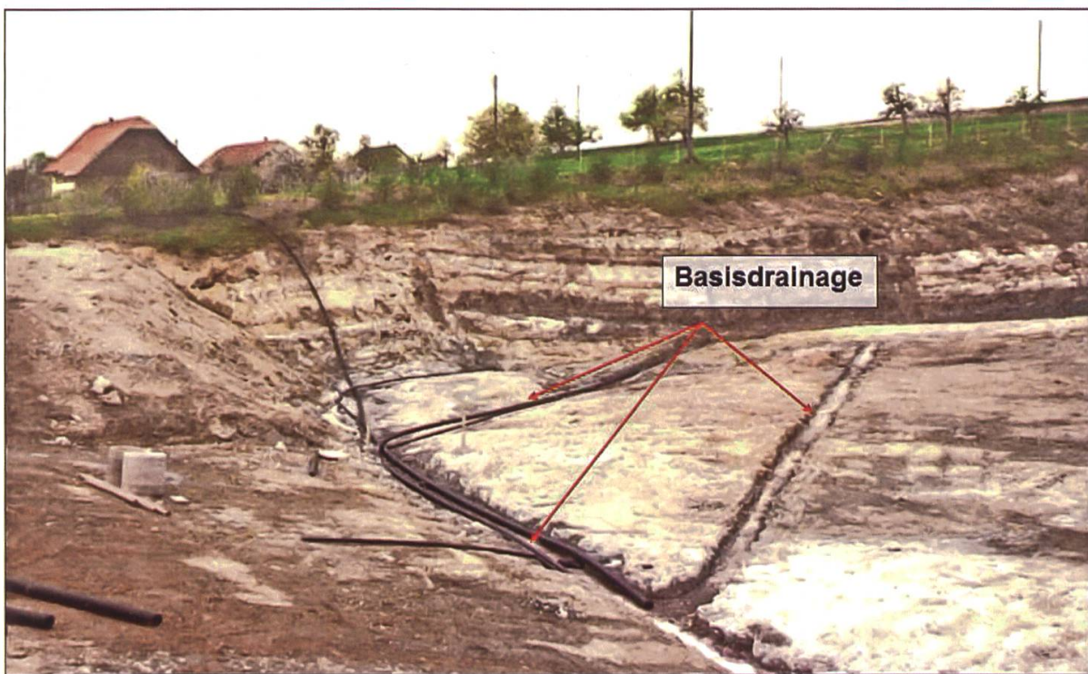
Abb. 4: Leere Grube 1977, vor Einbringen des Sondermülls. Anstehender Molassefels, rudimentäre Basisdrainage, keine Basisabdichtung, vergl. auch Abb. 3
