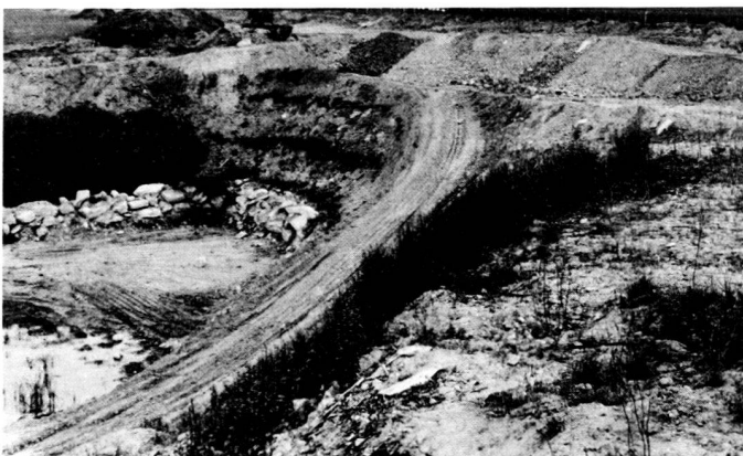
Links: Wiederaufbau einer Böschung mit Buschlagen, am Fuss Schaffung eines Spezialstandortes mit Steinblöcken, an anderen Stellen wurde eine mindestens 0,5 m starke Sandschicht bis in mittlere Böschungshöhe gezogen. Von der Bepflanzung der Böschungskrone sind nur 2 Eichen gut erkennbar.
