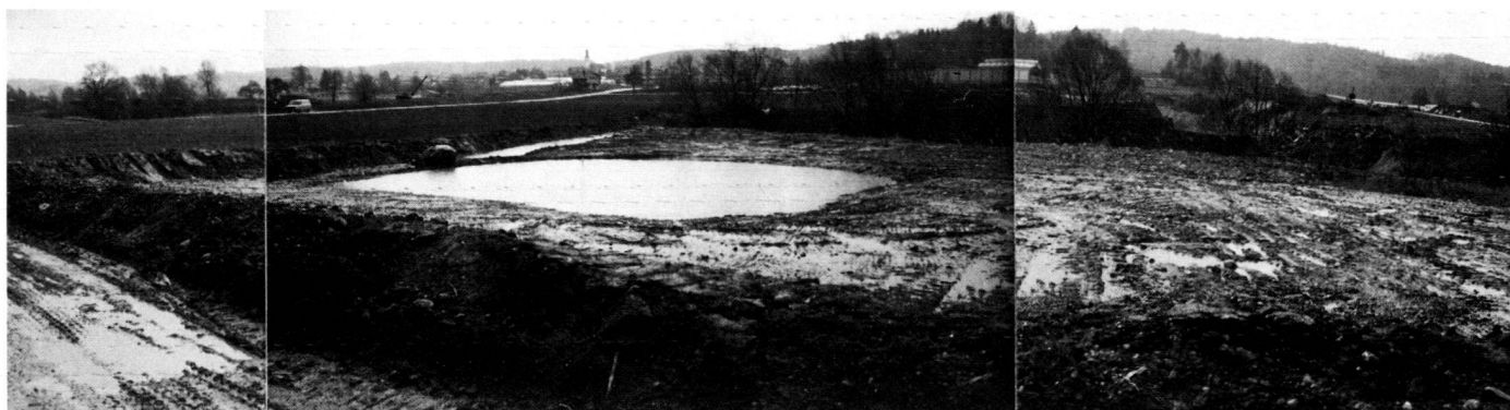
Nachträgliches Ausmulden einer ausgedehnten Auffüllungsfläche zum Sammeln des Oberflächenwassers; Ausgestaltung des Überlaufes als breite «Wagenspur» mit Einmündung in einen Filterkörper, damit keine Feinteile in das tiefliegende Laichgewässer eingespült werden können. Randliche Ausbildung eines Mähstreifens, der innen durch einen noch zu bepflanzenden Erdwall begrenzt wird. Foto: H. D. Koeppel
