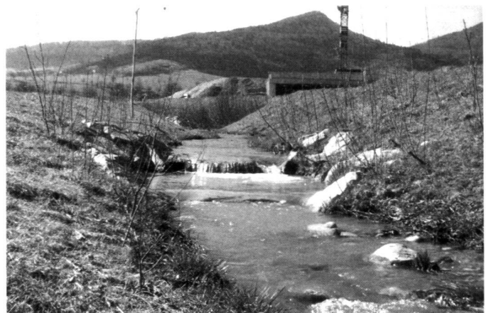
A gauche: Secteur inférieur de la rivière avec talus abrupts et élevés. Profonde coupure du terrain pour passer l'arête de la terrasse inférieure.
