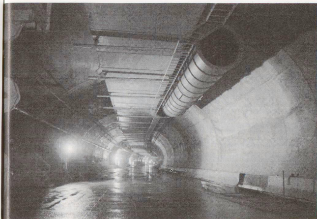
8 — Acceleratore da 57 kW disposto in calotta
