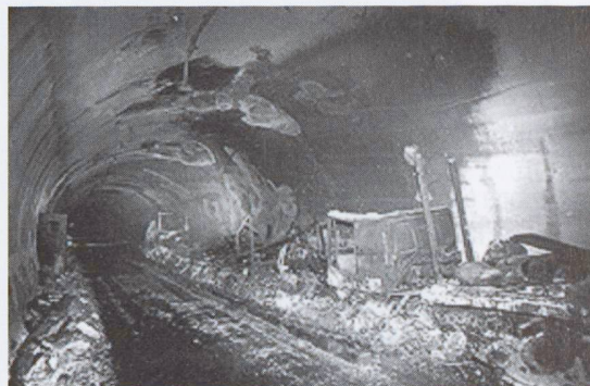
2 - La zona interessata dall'incendio, subito dopo il fatto
