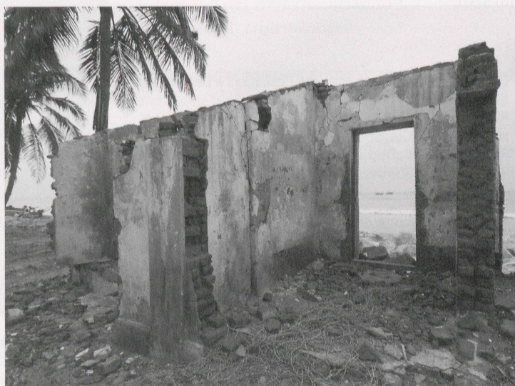
Fig. 1 – Casa distrutta dallo tsunami del 26 Dicembre 2004, stato del Tamil Nadu, India (foto D. Pittet)
