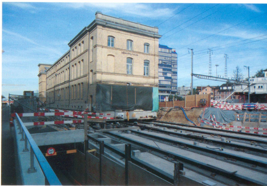
Una fase dello spostamento dell'ex sede amministrativa della Werkzeug- und Maschinenfabrik Oerlikon (MFO)
