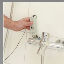
Localizzazione di perdite
