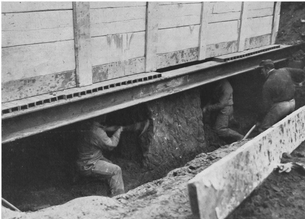
Abb. 54. Die Großgrabanlage wird mittels U-förmiger, schmaler Eisenschienen in Bergbaumanier unterfangen und anschließend auf drei Doppel-T-Eisen von je 500 kg Eigengewicht gelegt.
