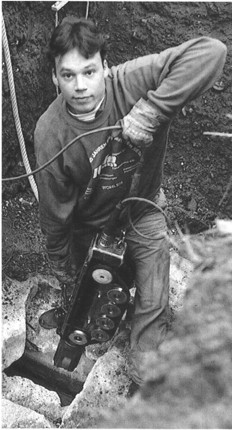
Abb. 18 Untersuchung der wasserführenden römischen Wasserleitung mit dem Kanalisationsfernsehen. Examen de la canalisation romaine à l'aide d'une caméra vidéo. Studio del condotto d'acqua romano per mezzo di una telecamera.
