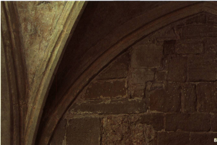
Abb. 8 Die Reste eines Zugangs zum Schlafrum der Konversen. Diese Türe wurde im 13. Jahrhundert wahrscheinlich im bestehenden romanischen Mauerwerk neu geschaffen, und im Zuge der Errichtung des überwölbten gotischen Kreuzgangs wieder aufgegeben.
