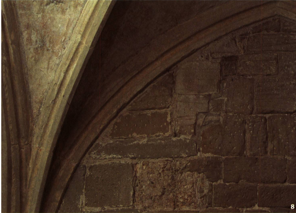
Fig. 8 Vestiges d'une porte donnant accès au dortoir des convers. Percée au 13 e siècle probablement dans les élévations romanes, elle a été condamnée par l'installation des voûtes dans le cloître lors du chantier gothique du 14 e siècle.
