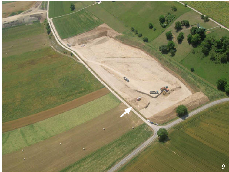
Fig. 9 Orny – Plan Marnand. Vue générale de la gravière, avec en bas à gauche l'emprise de la nécropole.
