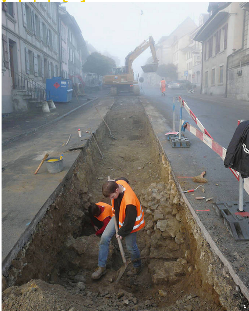
Fig. 1 Avenches. Dégagement des fondations de l'une des portes de la ville médiévale (Porte de Morat) dans une tranchée ouverte en 2008 dans la rue Centrale.
