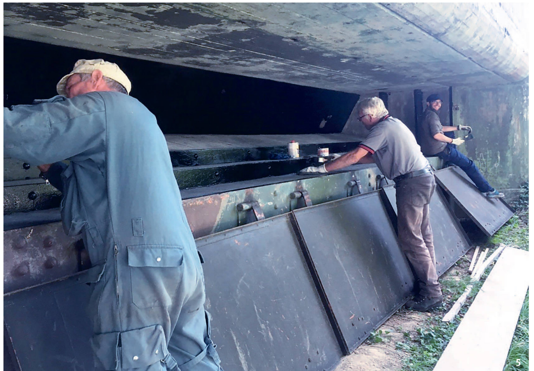
Abb. 5 Mitglieder des Vereins «Festungsgürtel Kreuzlingen» an der Arbeit bei einem Infanteriebunker im Raum Tägerwilten.
