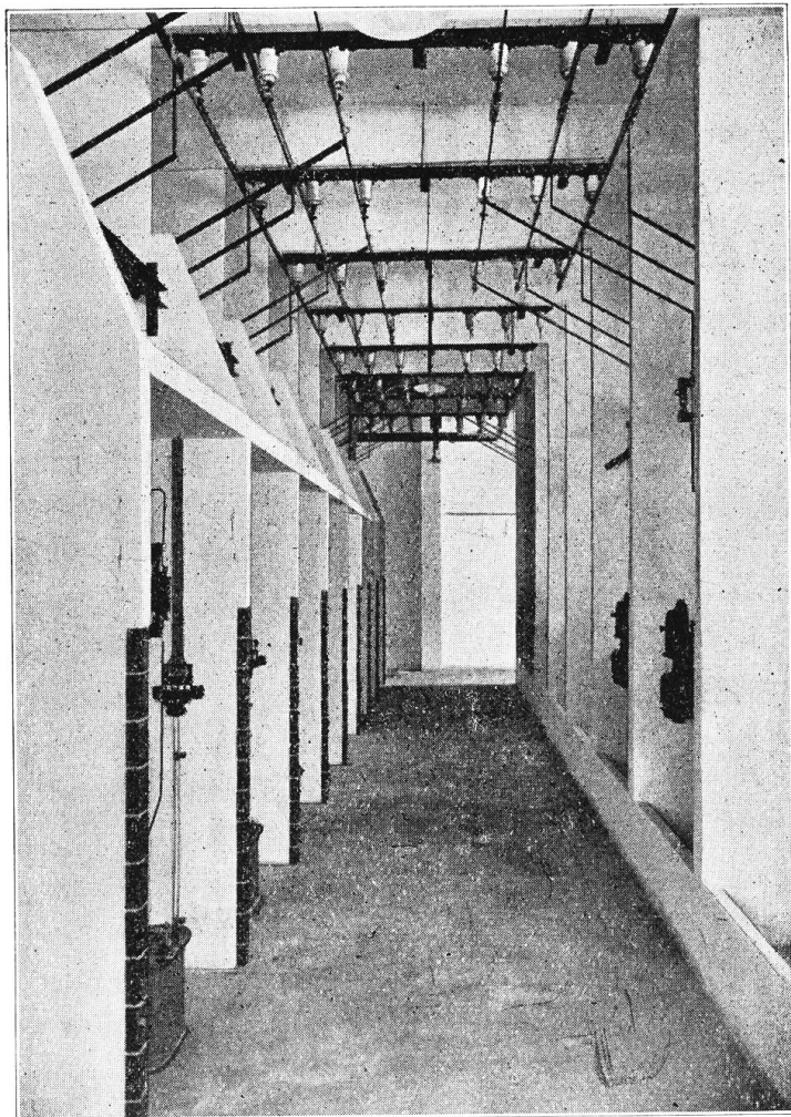
Fig. 22. Barres collectrices à 5600 volts.
