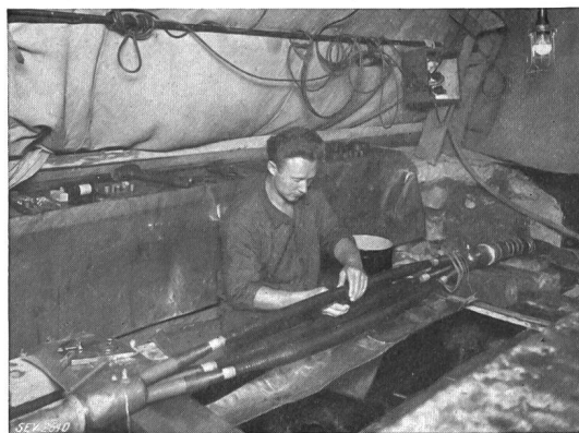
Fig. 17. Wickeln der Muffen. Links und rechts am Kabel sind die bleiernen Abschlusskappen zu sehen.
