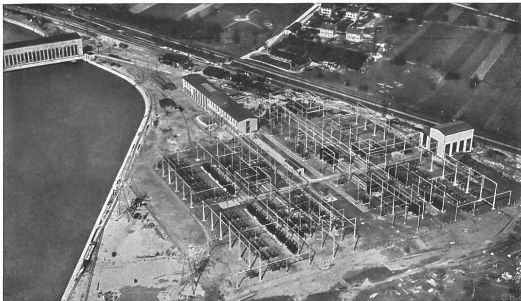
Fig. 23. L'installation de distribution sur la rive badoise, vue du sud-est, à vol d'oiseau.
