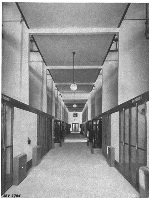
Fig. 24. Couloir de service de la distribution principale à 10,5 kV.
