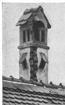
Fig. 23. Cas 127—32, Schwarzenburg, la cheminée endommagée.
