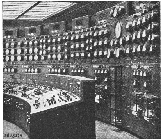
Fig. 10. Ausschnitt aus der Schalttafel des Kraftwerkes Conowingo.
