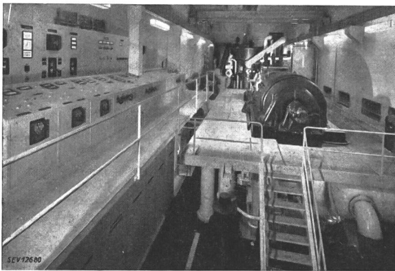
Fig. 9. Dampfturbinenkraftwerk Bern in Felskaverne mit Veloxkessel im Hintergrund (Brown Boveri)
