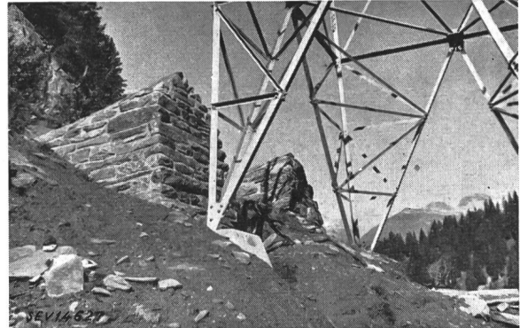
Fig. 30 «Kleine» Lawinenschutzmauern eines Tragemastes
