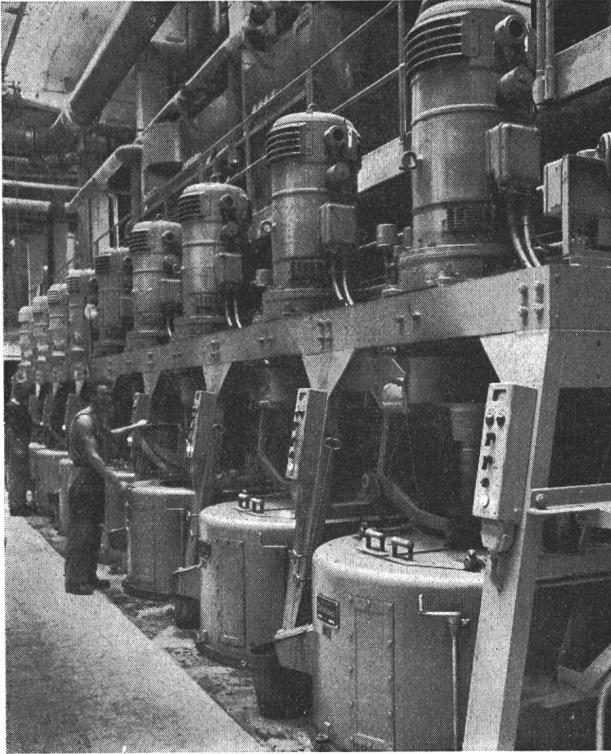
Fig. 2 Glasisolierte Hochleistungszentrifugen in der Zuckerfabrik Aarberg
