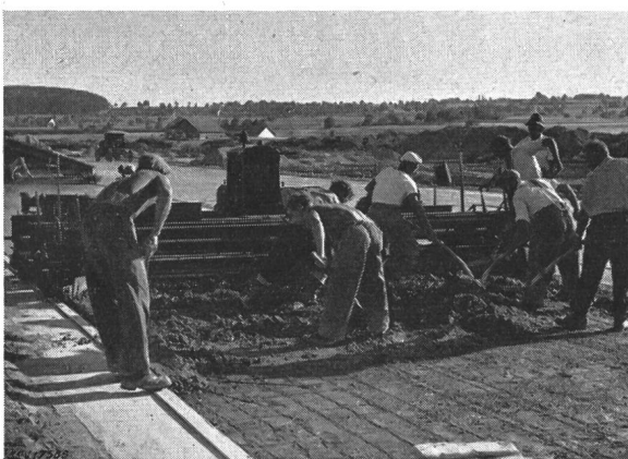
Fig. 8 Einbau des 27 cm starken Betonbelages mit dem Betonstrassen-Fertiger Im Vordergrund die Stahldrahtarmierung
