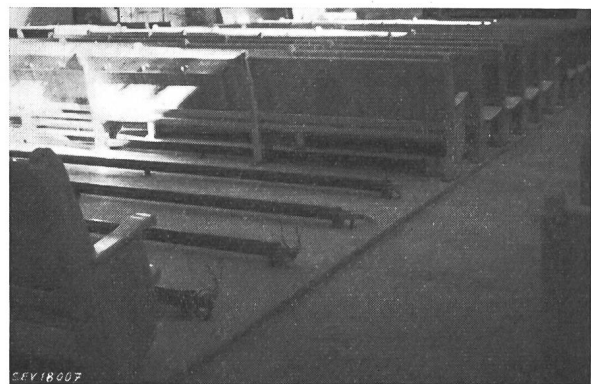
Fig. 2 Heizrohre unter den Fußschemeln Länge 6,65 m; Leistung 2,1 kW
