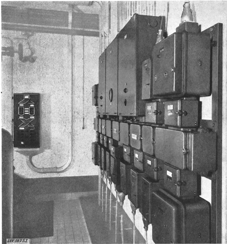
Fig. 7 Gekapselte Anlage für Fernsteuerung einer Eis-Transportanlage links: Steuertableau
