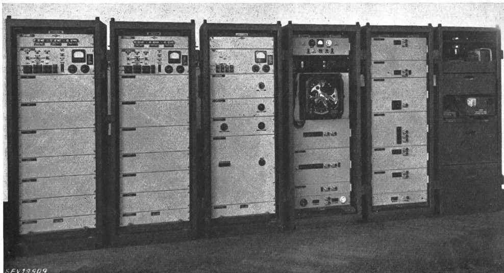
Fig. 8 Transportable Richtstrahl-Apparatur mit Trägerfrequenz-Mehrkanalzusatz für eine amerikanische Ölgesellschaft Schrank 1...3 Trägerfrequenz-Mehrkanal-Apparatur; Schrank 4 Richtstrahl-Empfangsgerät; Schrank 5 Richtstrahl-Sendegerät; Schrank 6 Zubehörmaterial
