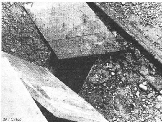
Fig. 10 Abgehobene Abdeckplatten des Kabelkanals Gewicht pro Stück ca. 25 kg
